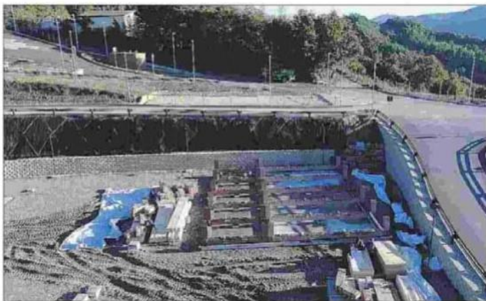
“Accupoli” ieri la partenza del cantiere per il montaggio della struttura in legno antisismica che nascerà ad Accumoli
